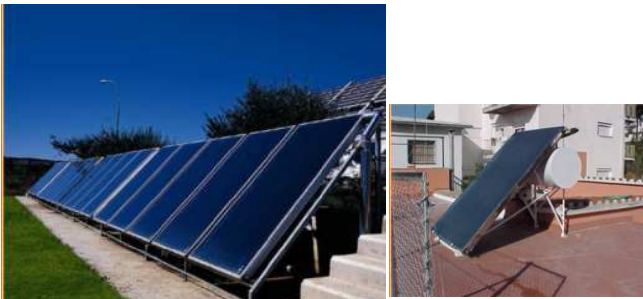
Instalaciones solares con colectores planos (sistema colectivo e individual) (Fuente: www.macosolar.cl )
