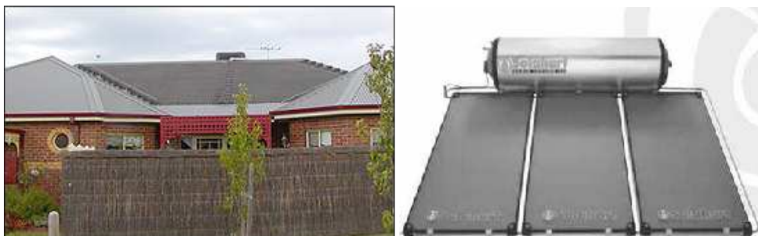
Colectores simples sin cubierta para el calentamiento de una piscina de vivienda y colectores planos con estanque de almacenamiento para el calentamiento de agua sanitaria (materiales importados Solahart) (Fuente: www.mekis-arnolds.cl )
